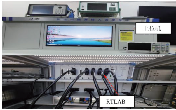
图 14 RTLAB 半实物平台
